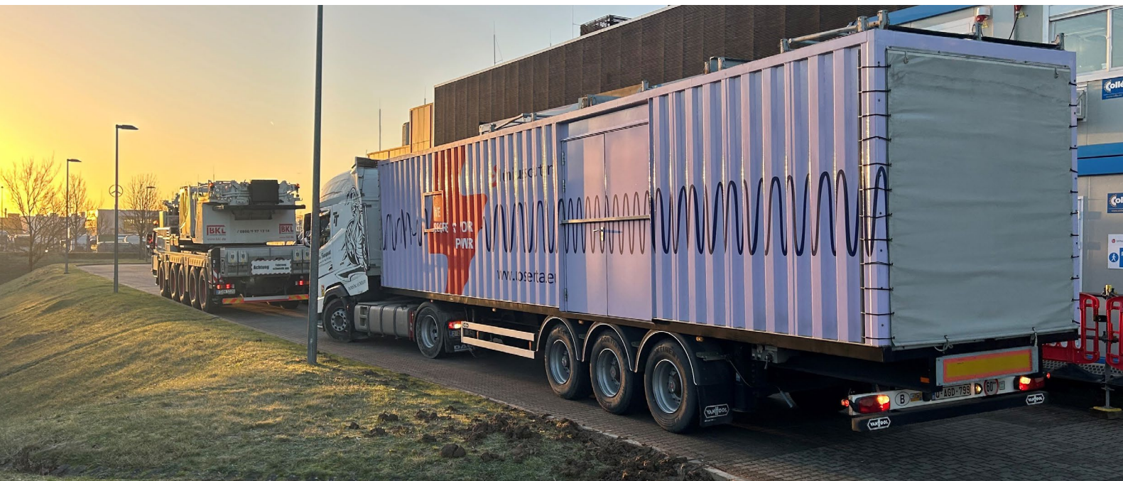
(Photo 8 - Système ASI mobile de 1600 kVA Luminus Solutions)
